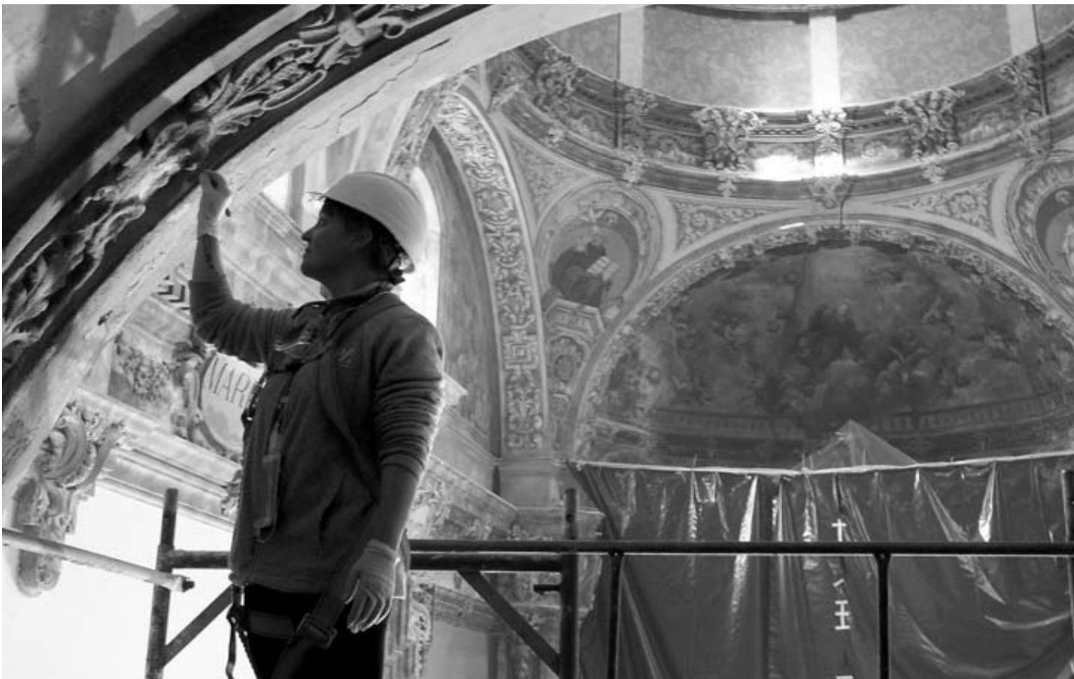
Una empleada trabaja en la rehabilitación de la capilla de la Virgen de la Barda, patrona de Fitero.
